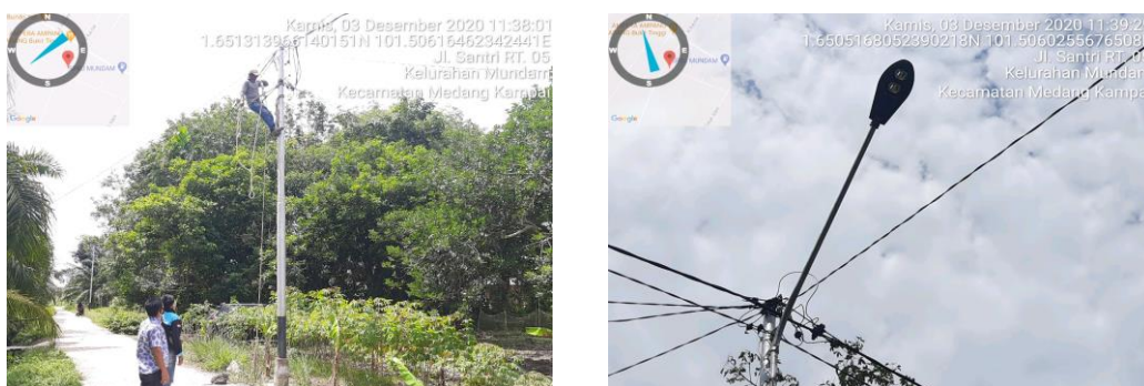
Gambar 2.5 Dokumentasi Kegiatan PJU (Pengadaan dan Pemasangan Lampu di Jalan Santri Rt. 05 Kelurahan Mundam)
