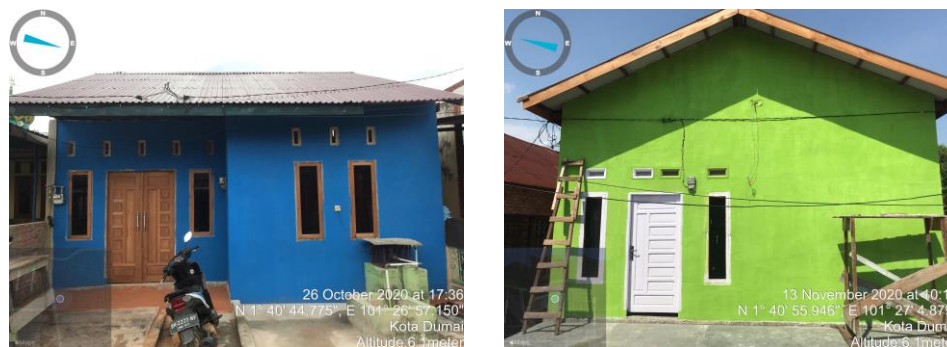
Gambar 2.4 Dokumentasi Kegiatan Pembangunan Rumah Tidak Layak Huni (Pembangunan Rumah Tidak Layak Huni di Kelurahan Buluh Kasap)
